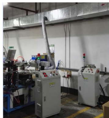
廢氣的收集和排放管道
